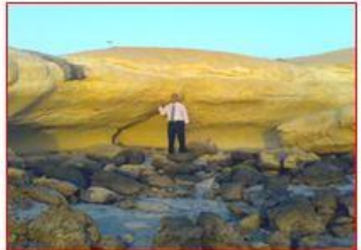
صورة (27) فجوات التفت البحري والأسقف المعلقة بجروف ساحل أبو سمرة، ويلاحظ الكتل الصخرية (المتهيلة) منها. التصوير: جهة الشرق.
