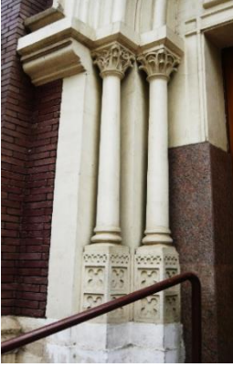
لوحة (10) الأعمدة بالجانب الأيسر لمدخل كنيسة القديس أنطونيوس البدواني بالقاهرة تصوير الباحثين
